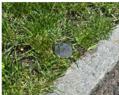
So sehen die Versenkregner eingezogen aus.
