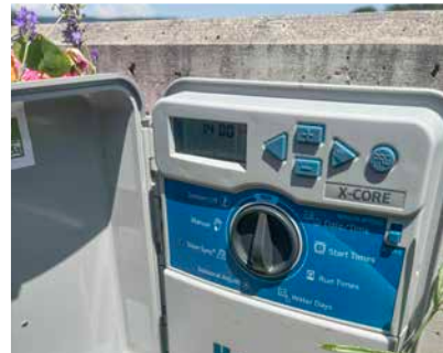
Oben: kleiner Sprinkler für Tröge Unten: Bewässerungssteuerung
